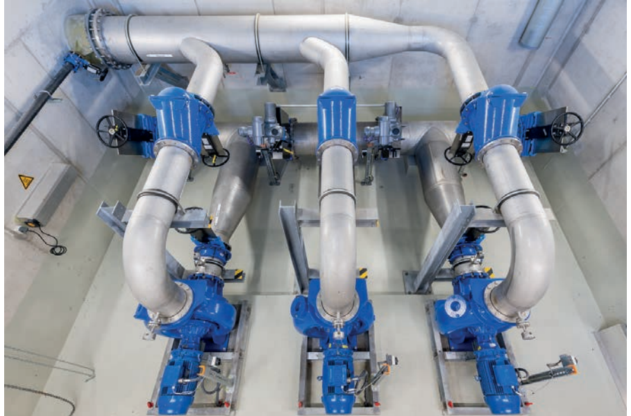
Pompkamer met droog opgestelde Hidrostal Lagerstoel pompen*
